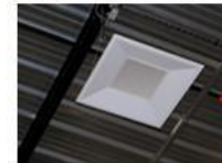
Eclairage contrôlé (tests en luminosité dégradée)
